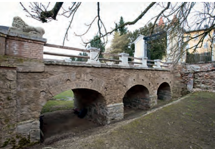
Haag i. OB, Lkr. Mühldorf a. Inn; Löwenbrücke über den Burggraben (Foto: BLfD, Michael Forstner 1581, 2011)
