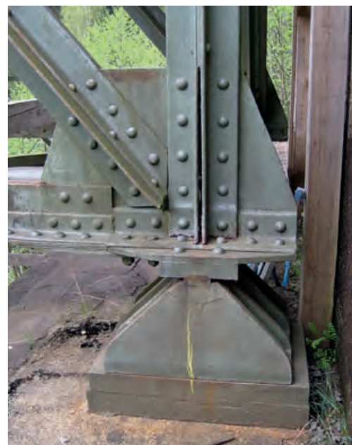
Deffernikbrücke; Auflagerpunkt des Fachwerkträgers auf dem südlichen Widerlager, mit Knotenblech und zusammengeklebten Stahlprofilen (Foto: BLfD, Julia Ludwar, 2011)
