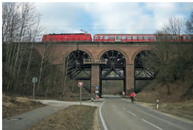
Höhbach-Viadukt bei Pleinfeld, Lkr. Weißenburg-Gunzenhausen; seit 1984 mit statischem Schutzgerüst (Fotos: BLfD, Ulrich Kahle; Aufn. oben aus dem Jahr 1980, Aufn. unten 2011)
