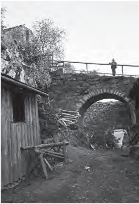
Thanstein, Lkr. Schwandorf; einbogige Fahrbrücke über Abschnittsgraben der Burgruine Thanstein (Foto: BLfD AM2009-12-7-01024923, Gelatinetrockenplatte, Friedrich Karl Weysser, um 1904)
