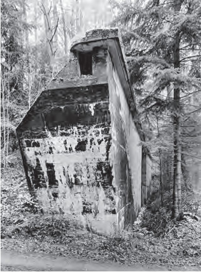
Bauwerk 105, Straßenunterführung „Roter Weg“ zwischen Burgsinn und Gräfendorf (Foto: BLfD, Eberhard Lantz)
