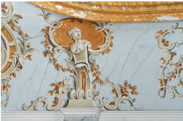
5. Kehle mit diagonaler Rissbildung über der Schilfrohrarmierung
