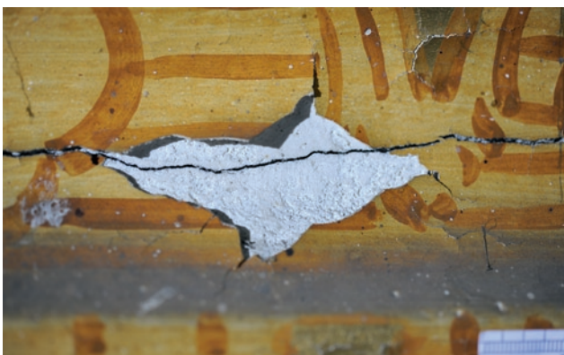
18. Stuckrahmung des Gewölbes, Detail mit Rissbildung und Fehlstelle
