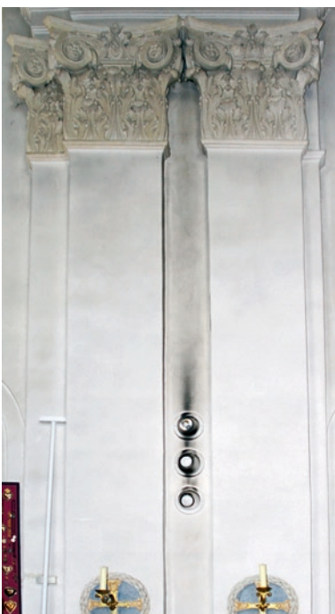
6. Blick in den Chorraum nach Osten; Halogenstrahler zwischen den Pilastern führten zu dunklen, schmierigen Rußfahnen an der Wand über den Leuchtkörpern
