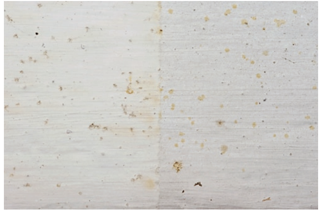
9. Südliche Chorkapelle; auch nach der Reinigung (rechte Bildhälfte) sind hellorange Pünktchen zu erkennen, es handelt sich vermutlich um Verfärbungen durch Melanin, die mit einem Neuanstrich abgedeckt werden können
