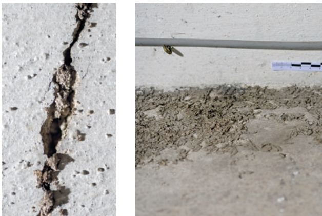
13, 14. Nördliche Kehle und Kranzgesims, Kokons eines Insektenbefalls
