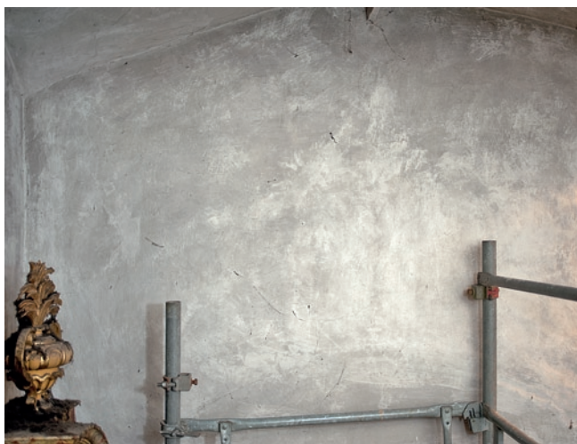
2. Südliches Seitenschiff, Westwand; typisches Erscheinungsbild der Wandfläche in Nachbarschaft zum Antoniusaltar: Dunkle Flecken durch Ruß und Feuchtreinigungen, helle Flecken durch partiellen Abrieb der Oberfläche bis auf die Grundierung, Okt. 2011 (Foto: Sven Oehmig)
