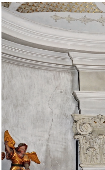
7. Wandfläche der nördlichen Chorkapelle; einfaches Abkehren der Schmutzschicht, vermutlich im Zusammenhang mit den Maßnahmen 2009, führte zu Schlieren und Kehrspuren auf der Fassungs Oberfläche, die sich nicht mehr rückstandslos entfernen lassen.
