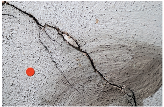
12. Kehle Nord, Riss im Putz mit lockeren Partien und mit Fehlstellen
