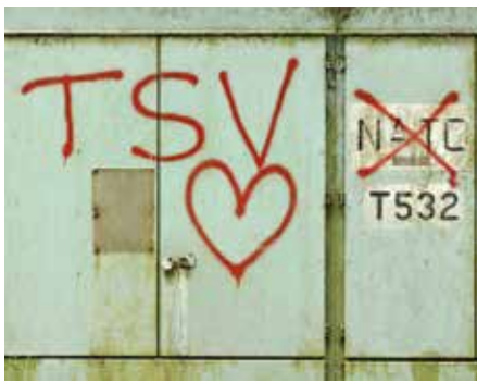
Graffiti auf einer Trafostation der Firma AEG. Die Station steht an der Forststraße südlich der Launching Area, 2016 (Foto: Privatarchiv Hermann Kerscher)
