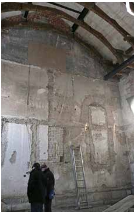
Ottensoos, Synagoge. Innenraum nach erfolgter Dachreparatur und Rückbau der Zwischendecke sowie der Raumtrennwände, 2012 (Foto: BLfD, Thomas Wenderoth)
