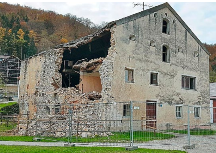
Jurahaus in Englgrösdorf, Gemeinde Kipfenberg (Lkr. Eichstätt), das 2020 nach einem Teileinsturz abgerissen wurde. Es wäre mit vertretbaren Mitteln zu retten gewesen. (Foto: BLfD, Marc Jumpers)
