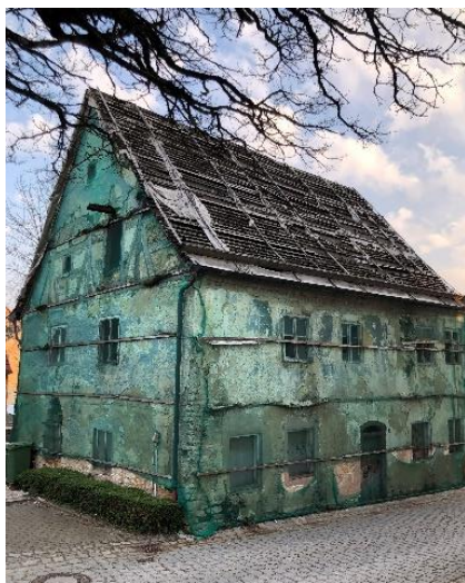
Notsicherung des Ackerbürgerhauses in Mittelfranken. ©BLfD.
