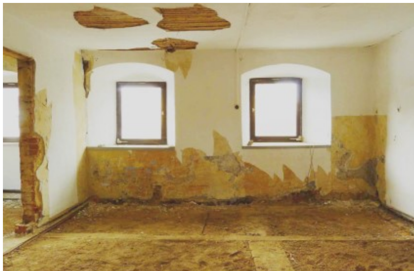
© (D. Härle) Sanierungsbedürftiger Wohnraum
