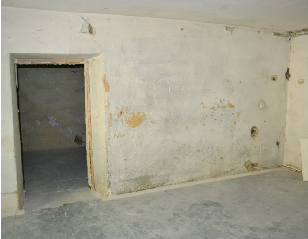
© (W. Ritter) Renovierungsbedürftige Räume
