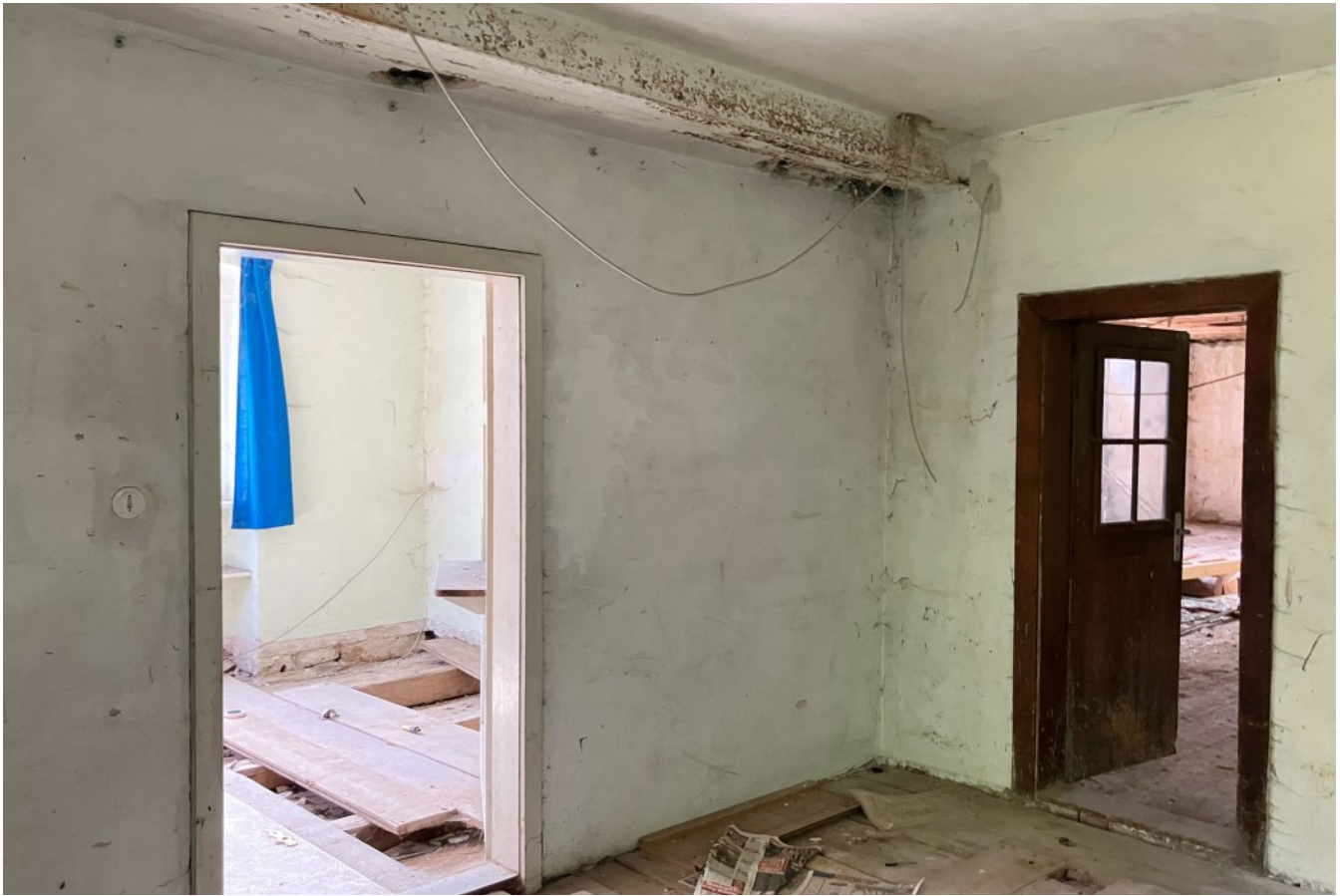
© (Die Denkmalschutz Immobilie) Sanierungsbedürftige Wohnräume im OG
