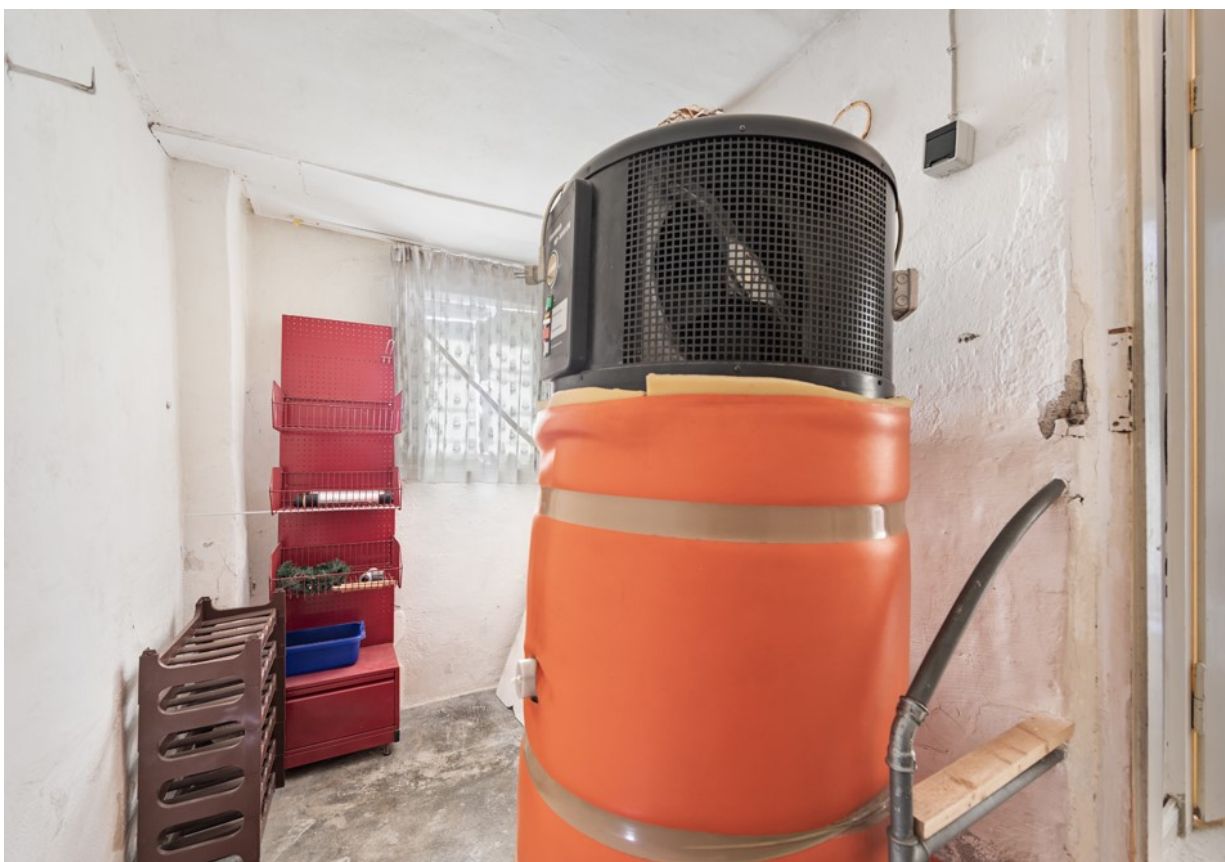
© (Von Poll Immobilien GmbH) Warmwasserboiler im EG
