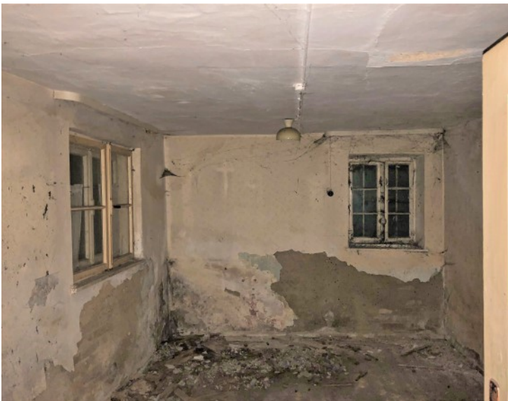
© (E.d.A.) Sanierungsbedürftiger Wohnraum
