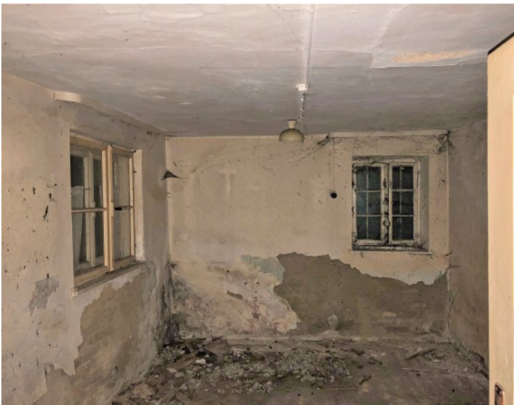
© (E.d.A.) Sanierungsbedürftiger Wohnraum
