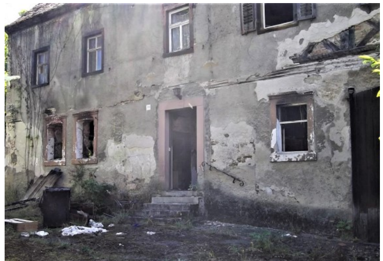
© (R. Selig) Ehemaliges Wasserschloss durch Brandschaden beschädigt
