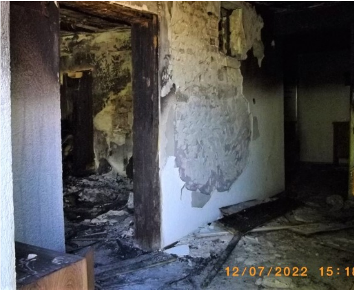
© (R. Selig) Brandschaden in einem Zimmer im EG
