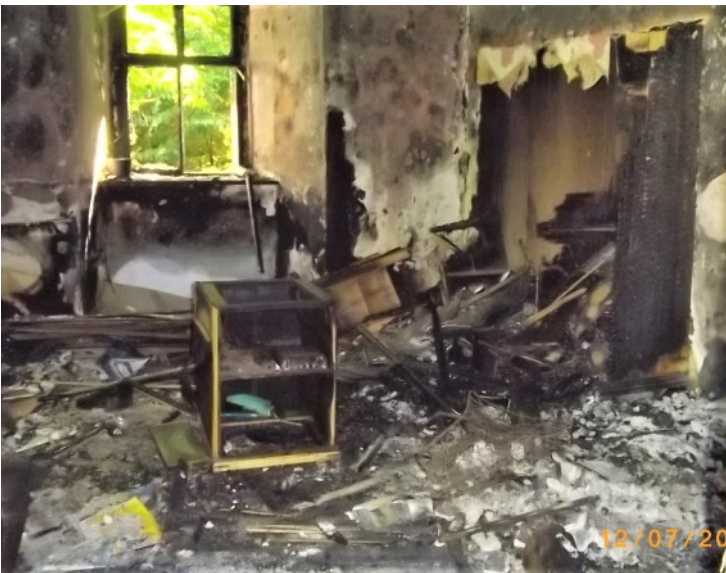
© (R. Selig) Ausgebranntes Wohnzimmer des EG
