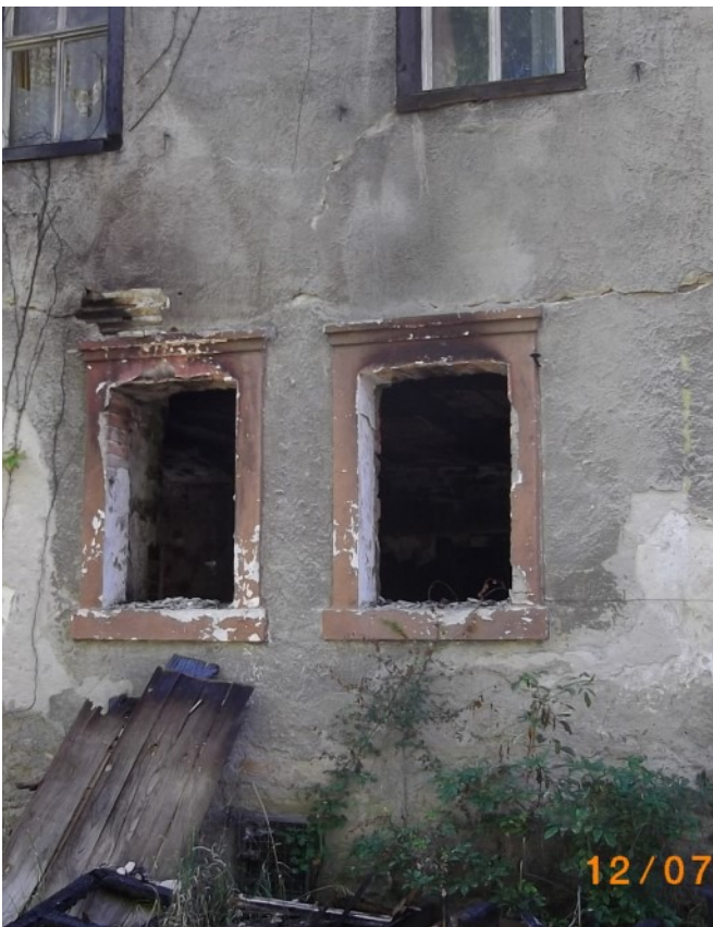
© (R. Selig) Brandschaden im Wohnzimmer des EG
