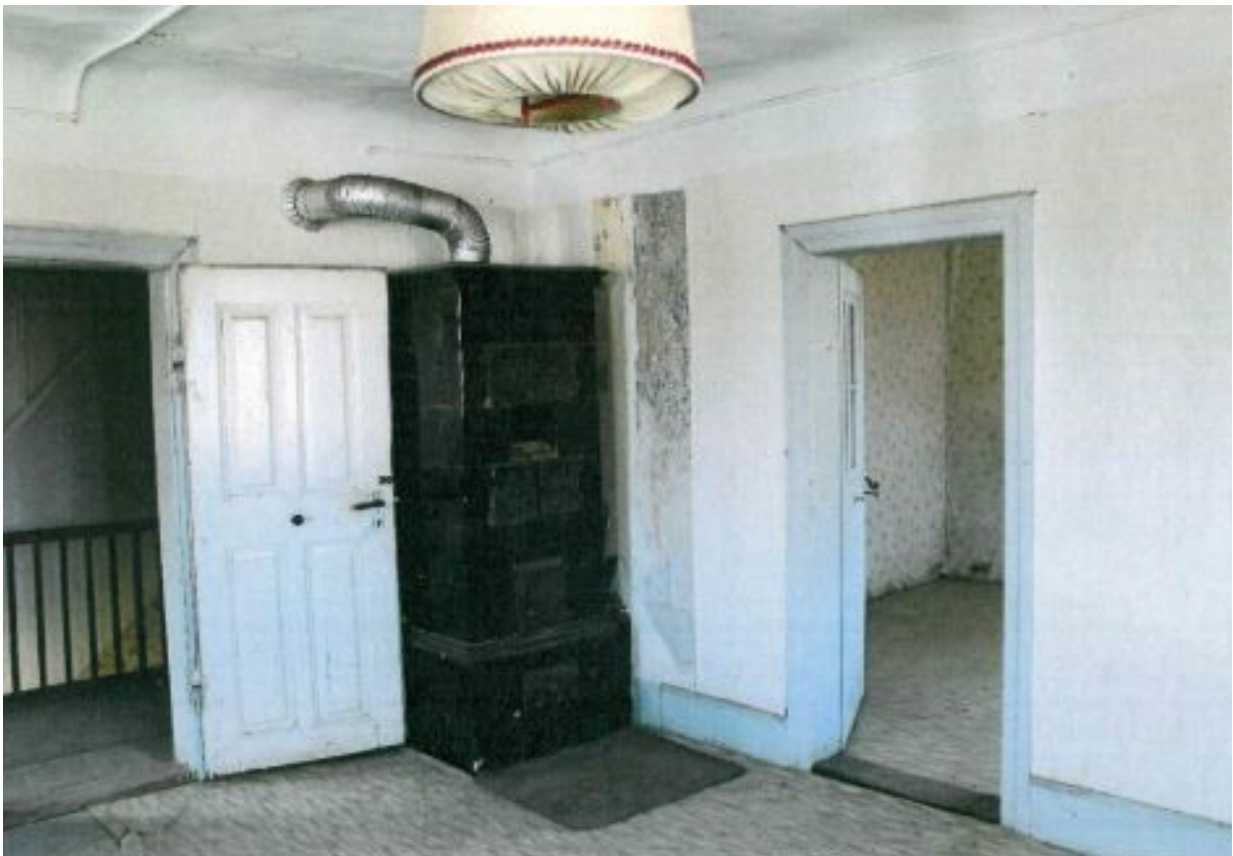
© (Fr. Brell) Sanierungsbedürftige Wohnräume mit Kachelofen im OG
