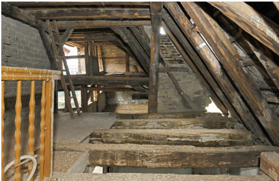
© (G. Gronauer) Historischer Dachbereich
