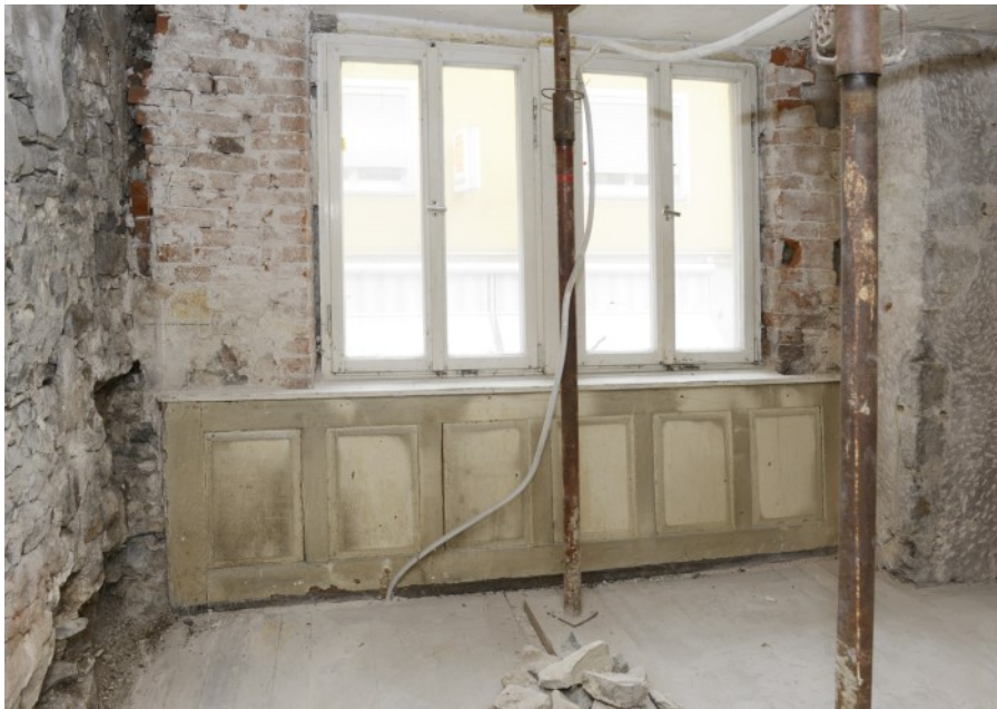
© (G. Gronauer) Sanierungsbedürftiger Wohnraum
