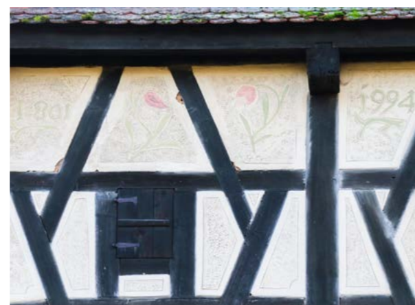
Farblich abgesetzte Differenzierung der Ornamentik im Putz eines Gebäudes im Landkreis Bamberg (Foto: BLfD, Laura Deglmann)
