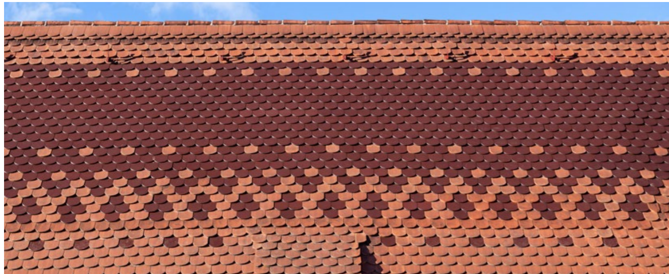
Indach-Photovoltaikanlage, Alte Münze (Foto: BLfD, Denise Lonis)
