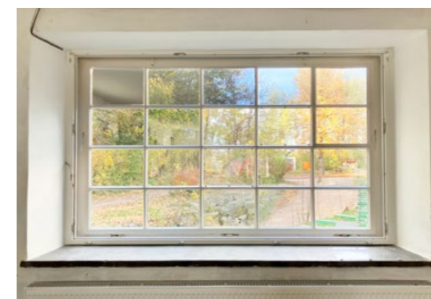
Reallabor: Exemplarisches Fenster mit Adhäsionsfolien unterschiedlicher Filterwirkungen (Foto: IBP, Timo Hevesti-Toth)
